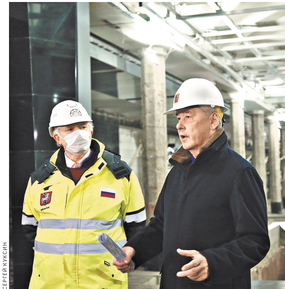
Сергей Собянин осматривает ход ремонта станции, которая скоро заработает в составе южного участка БКЛ.
